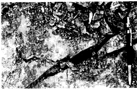
写真-2 多野岳崩壊 (A) のすべり面付近にみられる地層弱面
