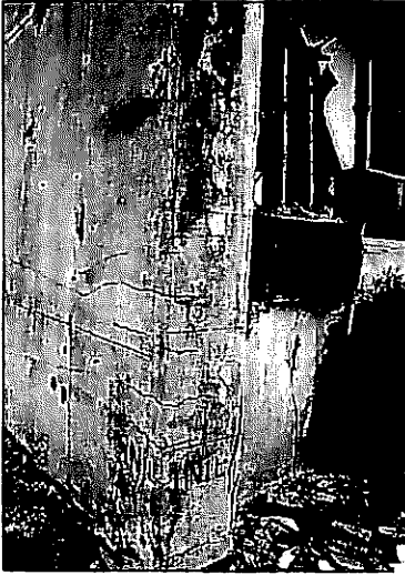
写真-19 1階N通り妻側（1通りスパン） 脚部の曲げ亀裂を生じた柱および耐震壁
