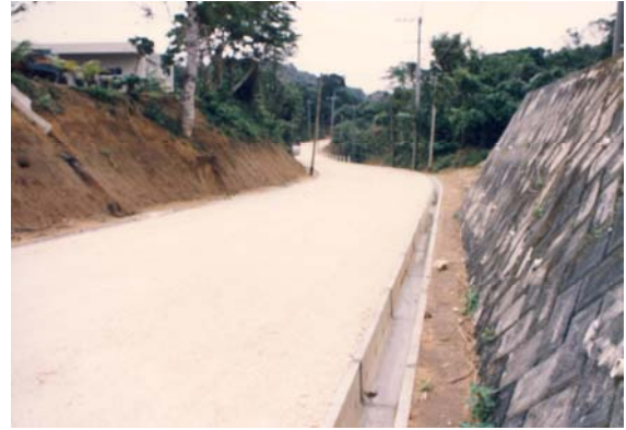
ガラス室、農用機械格納庫付近の舗装直前の状態 — 平成 3 年(1991)3 月 —
