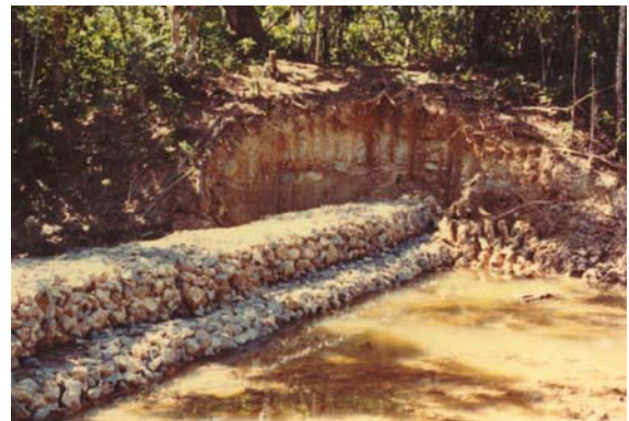
研究圃場の土砂流出防護柵
