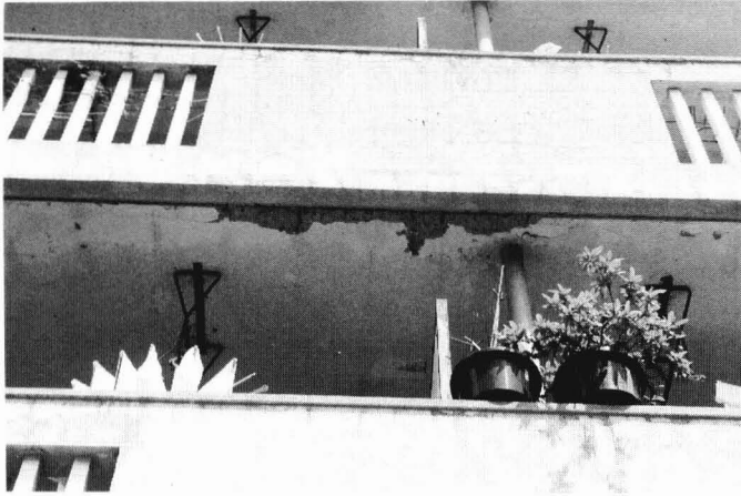
写真-13 浜川団地2号棟ベランダ水切り部の損傷状況
