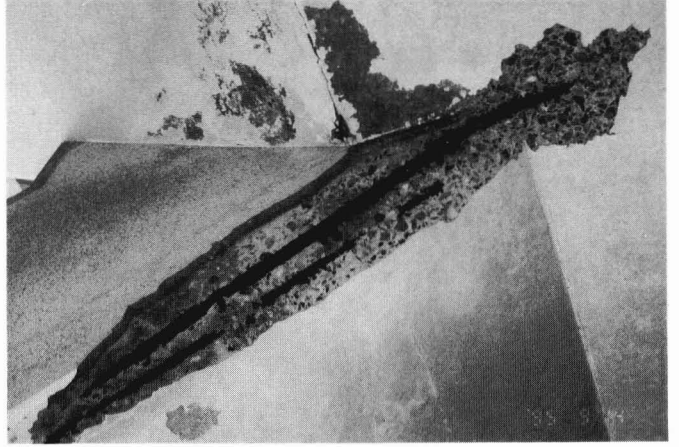
写真-16 志真志団地5号棟階段室配管部の損傷状況
