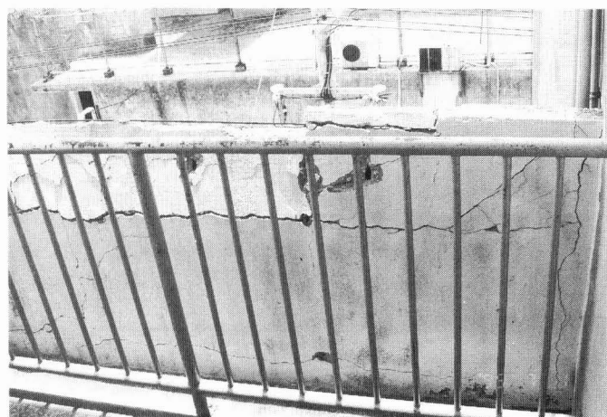
写真-9 石川市街地住宅階段室コンクリートの損傷状況
