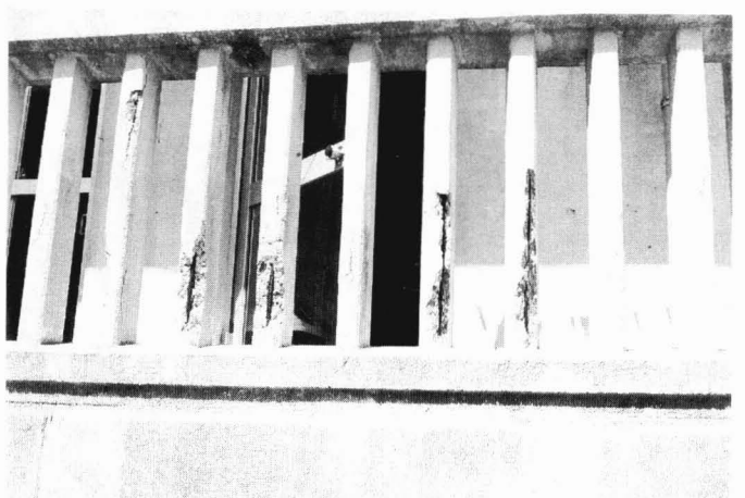
写真-18 愛知団地A-3号ベランダ手摺りの損傷状況
