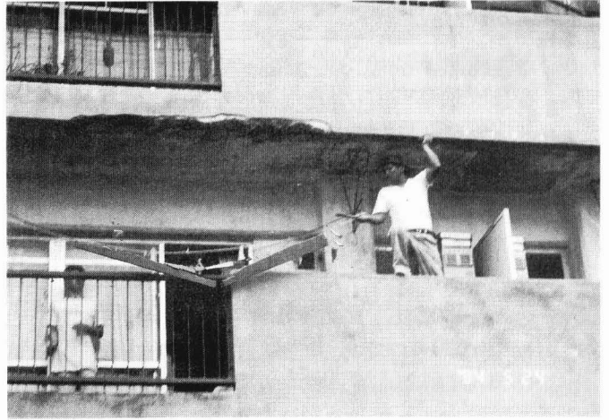
写真-4 豊見城団地ベランダ水切り部の損傷を受けたかぶりコンクリートの落下状況
