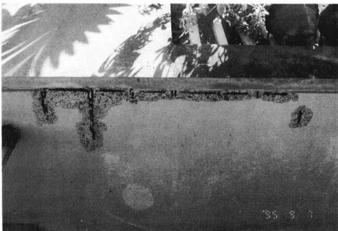
写真-15 神森団地3号棟ベランダ水切り部損傷状況
