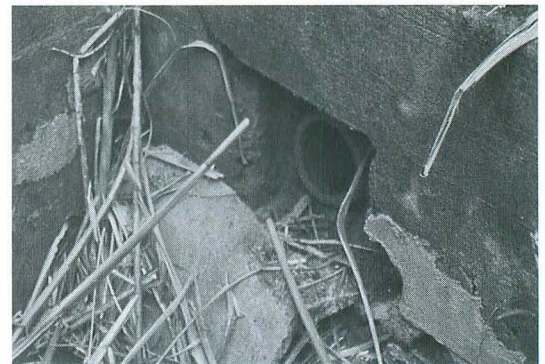
写真14：半地下式の枡内の配水管（南西から）
