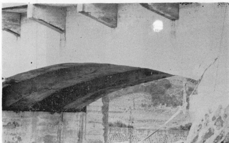
Photo-4 奥武橋（玉城村）の床版片持部
