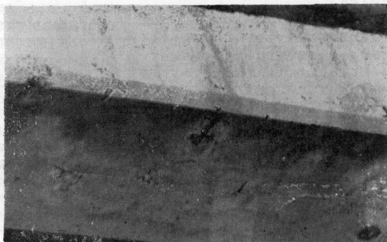
Photo-3 陽迎橋（浦添市）の床版片持部
