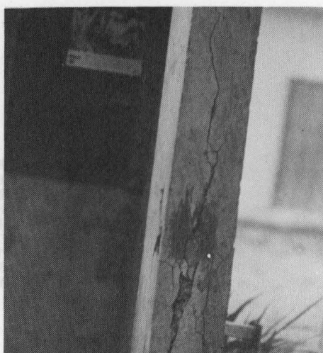
写真-14 外廊下柱 楚州小1号棟 (S27)
