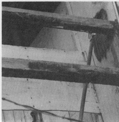
写真-38 2階北階段手すり 辺土名小8号棟 (S38)
