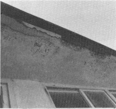
写真-31 佐手小2号棟 (S30) 北面軒スラブ
