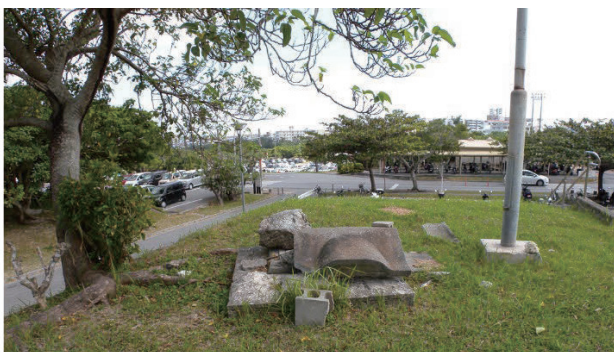
図18. 台風で破壊されたニフェーマーチューの拝所 注：周辺の樹木は伐採され、拝所の保護機能は失われた。
