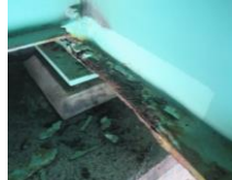
G4桁 塗装再劣化部
