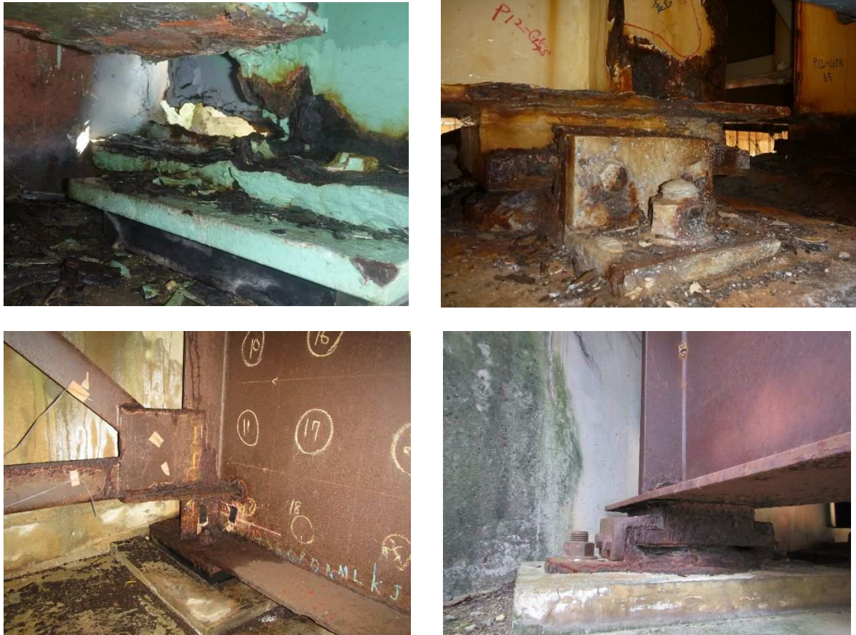
図 1.1.1 桁端部腐食事例
