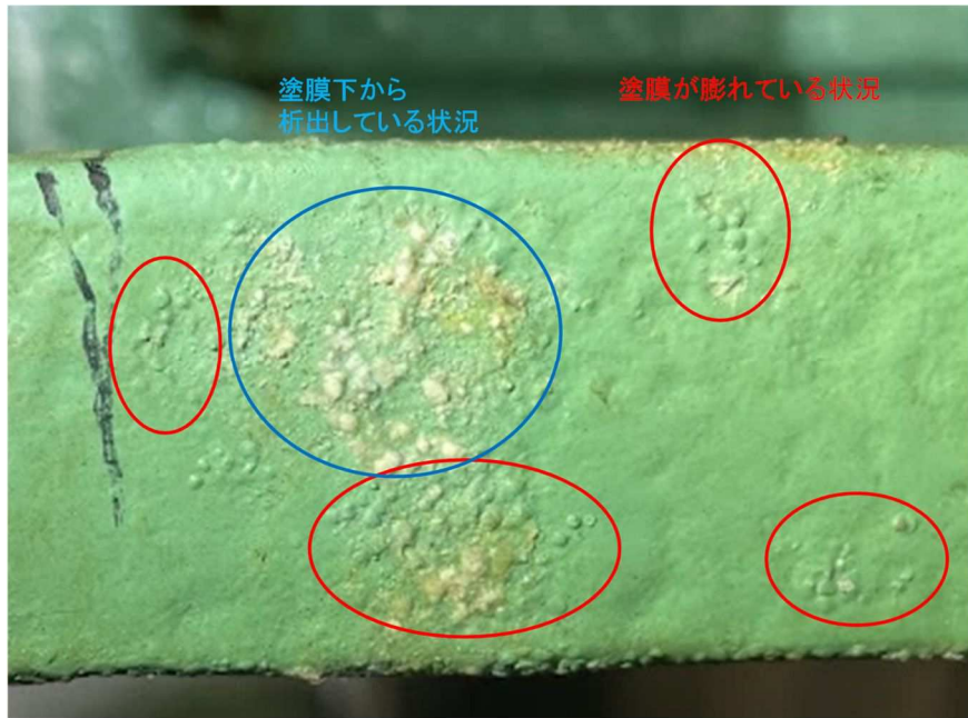
下フランジ側面の拡大写真
